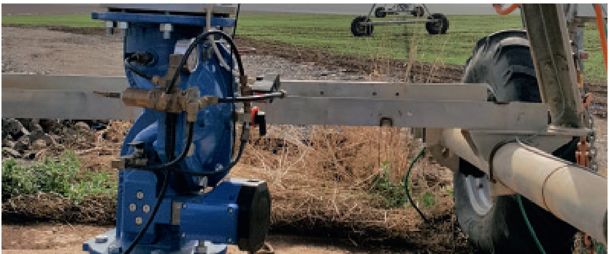
Válvula de control con contador ultrasónico ULTRAF instalada en pivot.
